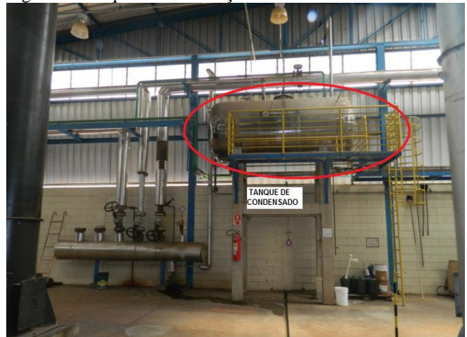
Figura 3: Tanque de alimentação da caldeira
